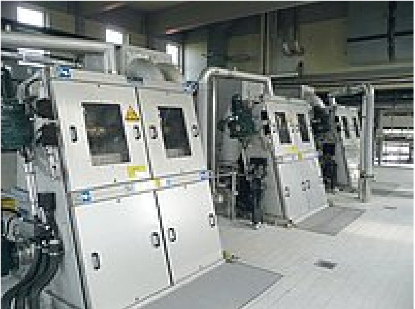
Three HUBER RakeMax® screens on WWTP Magdeburg/Gerwisch
